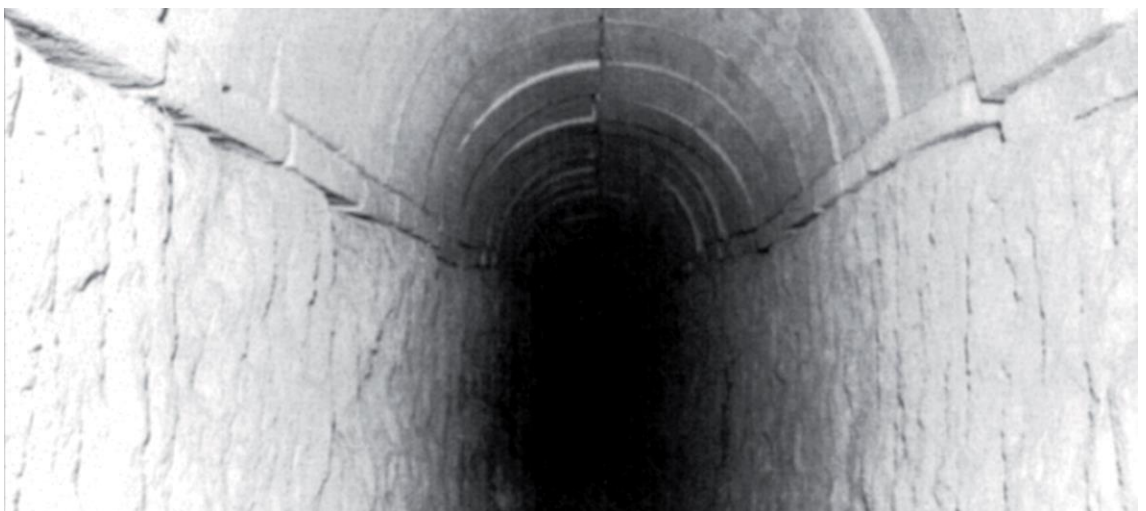
Figura 10. Detall de la mina. (Informe dels Mossos d'Esquadra)
